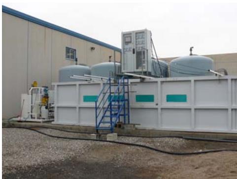
Figura 1. Planta Piloto para simulación de descargas
