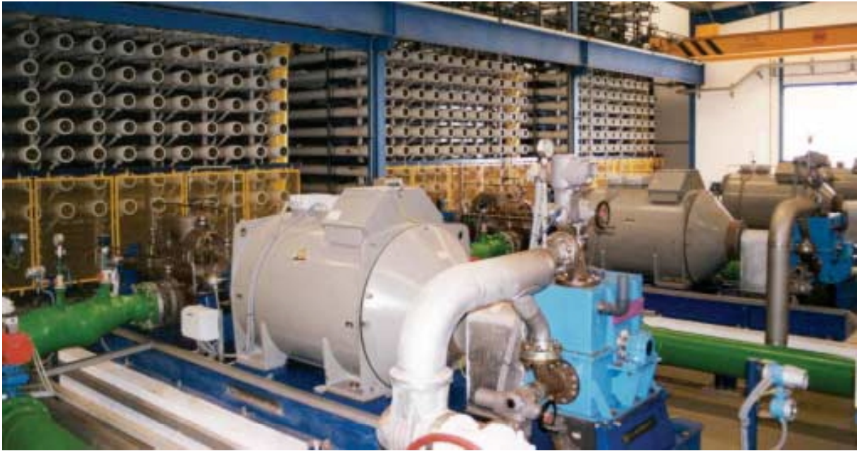
Fig. 3. Grupo bomba y turbina de la Planta Lanzarote IV.
