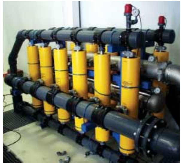
Fig. 8. Recuperador de energía ERI. Planta de Mazarrón.
